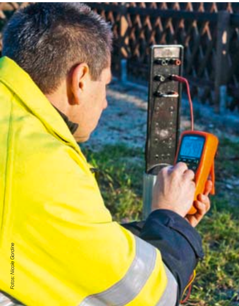
Die regelmäßige Kontrollmessung verrät Schwachstellen im Kunststoff-Schutzmantel der Gasrohre
